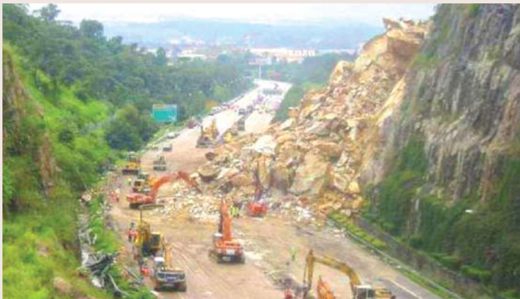
Rajah 2.6: Gelongsoran batu di Km. 21.8 Lebuhraya Klang Utara
